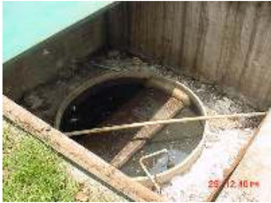
Figura 3a. Sedimentador primario del humedal artificial de flujo horizontal, HAFH, ubicado en el Vivero Forestal de Coyoacán de la Ciudad de México, México
