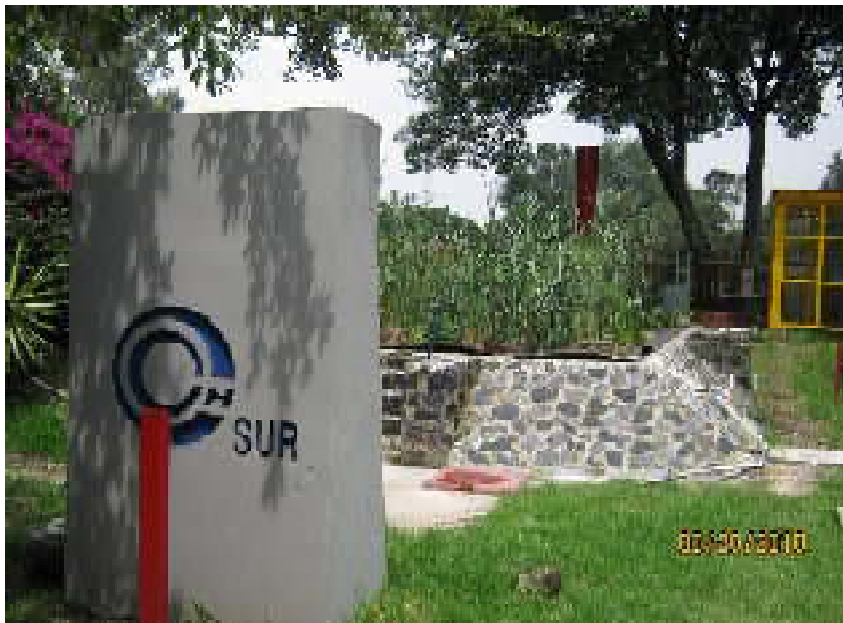
Figura 12b. Humedal artificial de flujo horizontal, HAFH, construido en el Colegio de Ciencias y Humanidades Plantel Sur, que sustituyó el de flujo vertical de la Zona Cultural (ver la tapa del segundo sedimentador, ya que la fosa séptica del Edificio de Idiomas (Figura 12a) es realmente un sedimentador primario, pues su tiempo de residencia hidráulico es de un día y en ese tiempo no pueden biotransformarse los contaminantes disueltos y coloidales
