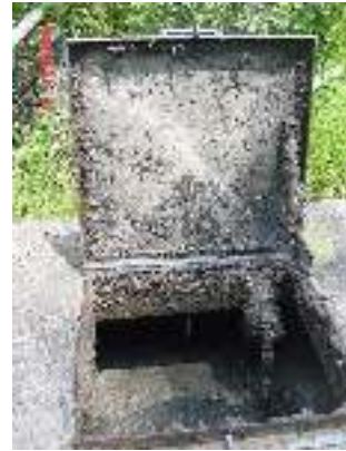
Figura 3b. Sedimentador primario del humedal artificial de flujo vertical, HAFV, localizado en la Zona Cultural de la Ciudad Universitaria al sur de la Ciudad de México, México (ya no existe)
